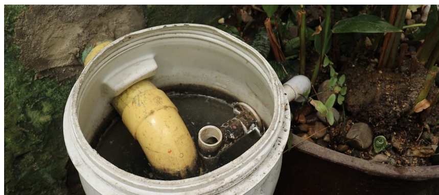
La trampa de grasa y el biofiltro natural, parte importante del proceso.
