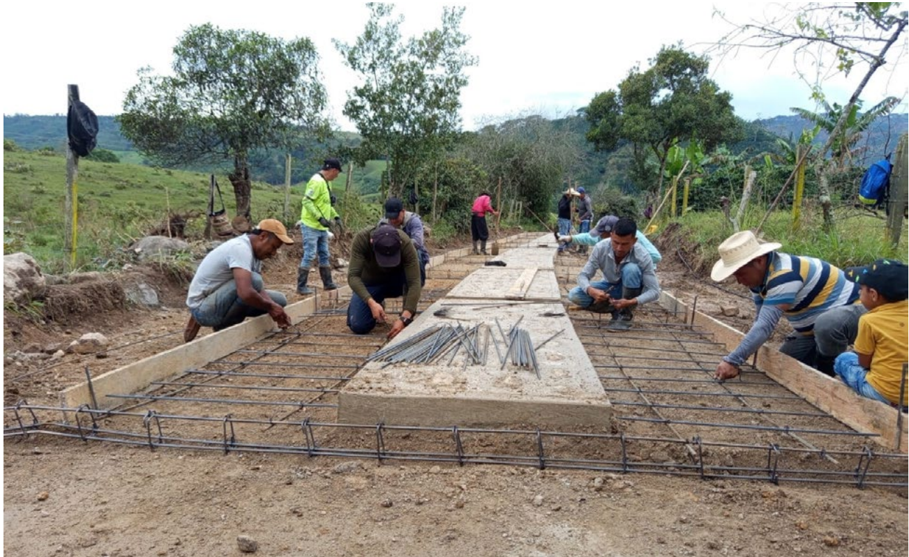
Durante el desarrollo de la obra la comunidad estuvo siempre dispuesta al trabajo con la contribución de la mano de obra.
